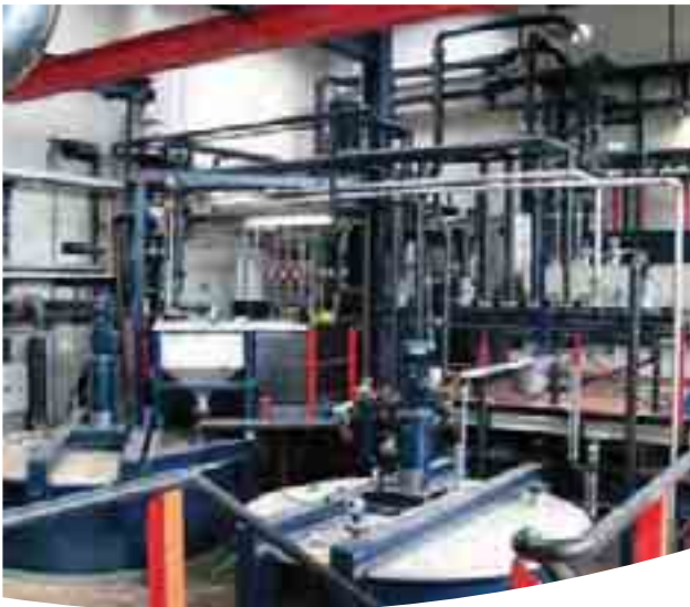
Teilansicht der Produktionsanlage für Kupfersalze
